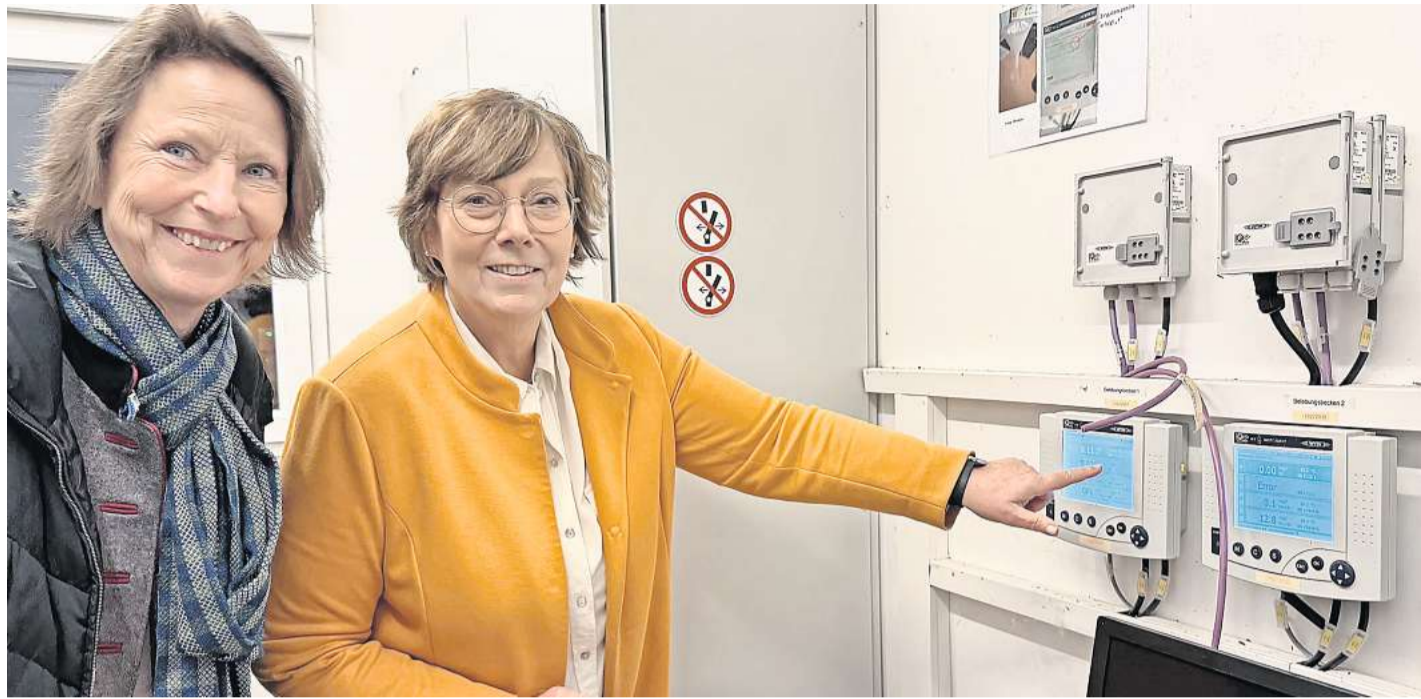
Innenministerin Sabine Sütterlin-Waack (rechts) und Sandra Carstensen (beide CDU) stehen vor einer Schalttafel im Plöner Klärwerk und informieren sich über mögliche Ausfälle der kritischen Infrastruktur.
